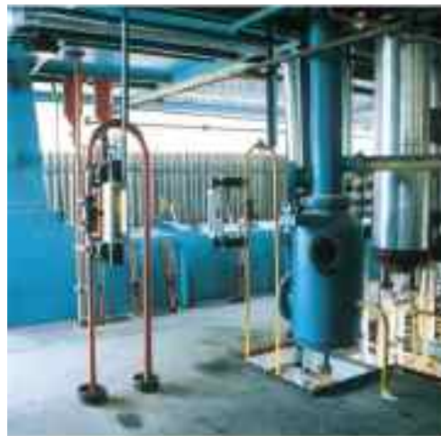
溶剂提取装置内部视图
