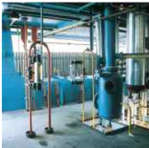
Innenansicht der Lösungsmittel-Extraktionsanlage
